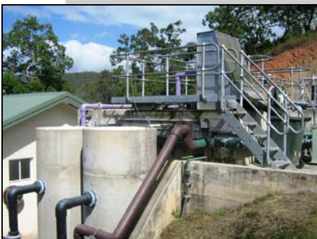
Wujal Wujal STP (QLD)
